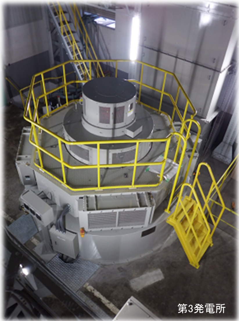
幌満川水力発電所
