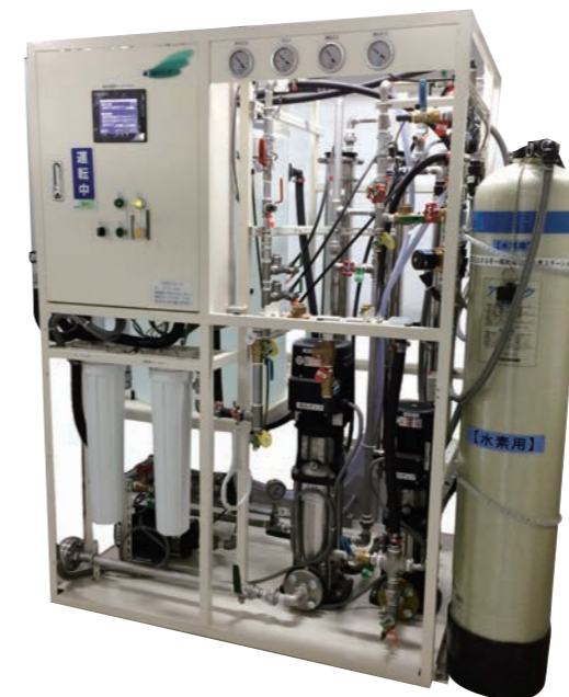
MR パック (純水製造装置)
