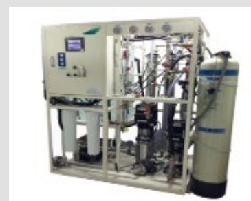
純水製造装置
