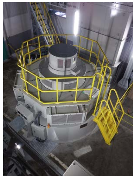
第3発電所 2号発電機
